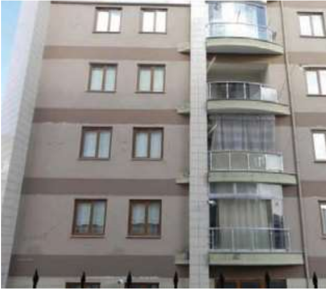
(c) Cephe Duvarlarında Gözlenen Çatlaklar
