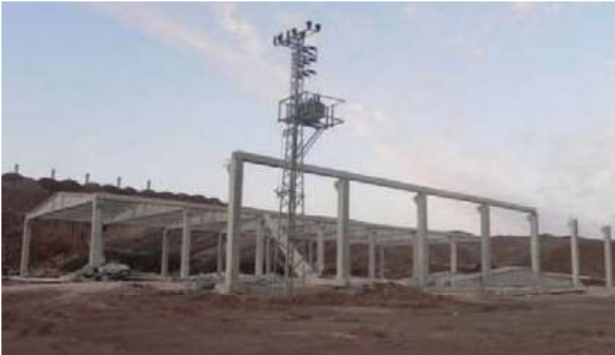
Fotoğraf 3.4 - Hasarlı Sanayi Yapısı (B)
