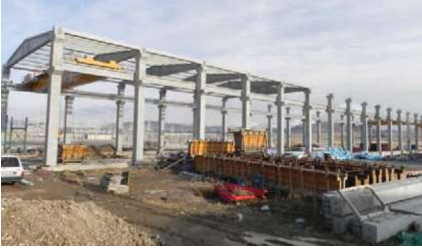
Fotoğraf 3.3 - Hasarlı Sanayi Yapısı (A)
