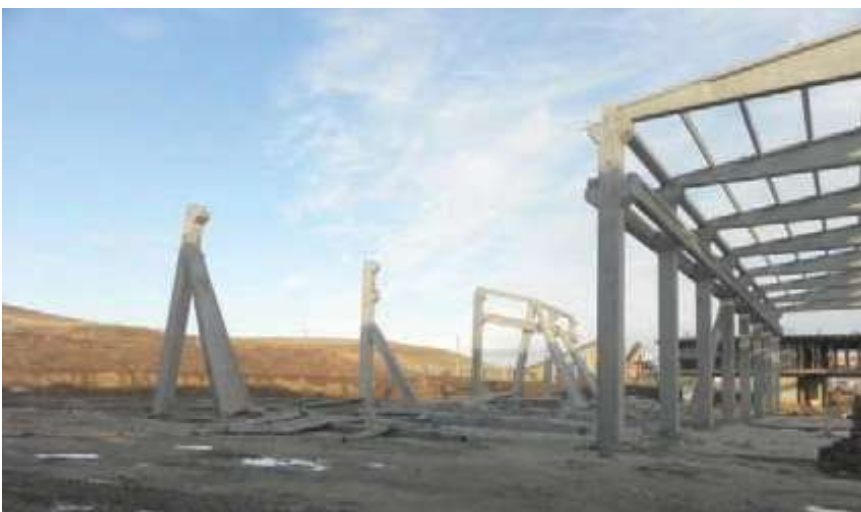
Fotoğraf 3.5 - Hasarlı Sanayi Yapısı (C)
