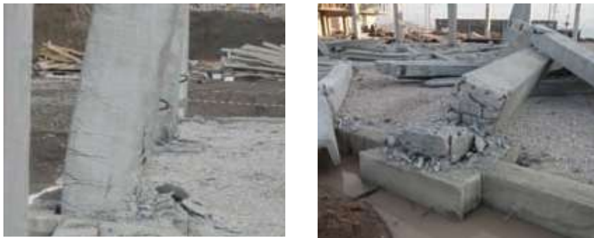
Fotoğraf 3.7 - Kolon Tabanında Mafsallaşma ve Güç Tükenmesi
